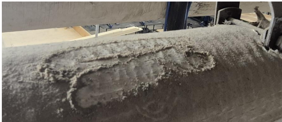
Figure 3-7 - Poussière sur un conduit en hauteur
