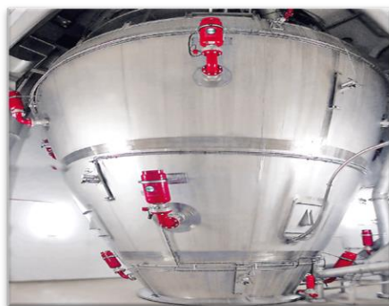
Figure 9-7 - Exemple de de bouteilles de suppression chimique sur un équipement (Source : REMBE)
