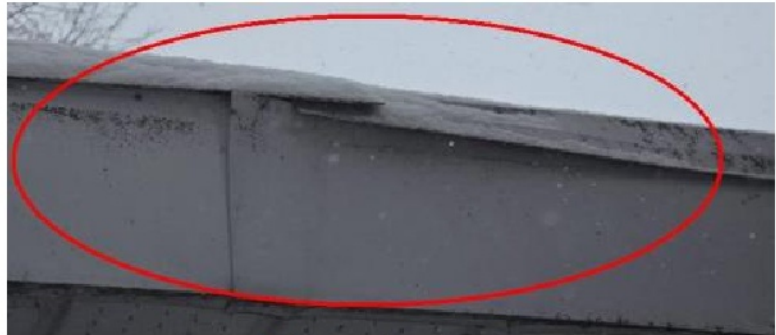
Des dommages sont observés à la bordure du toit.
