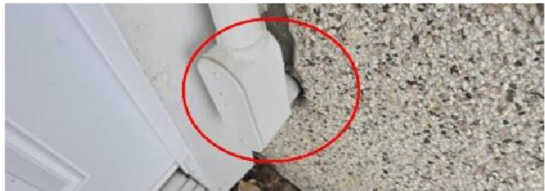
Un trou non colmaté est visible sur la fondation. Risque d'infiltration d'eau. Suite à la prise de possession, faire colmater l'ouverture dans le mur de fondation.
