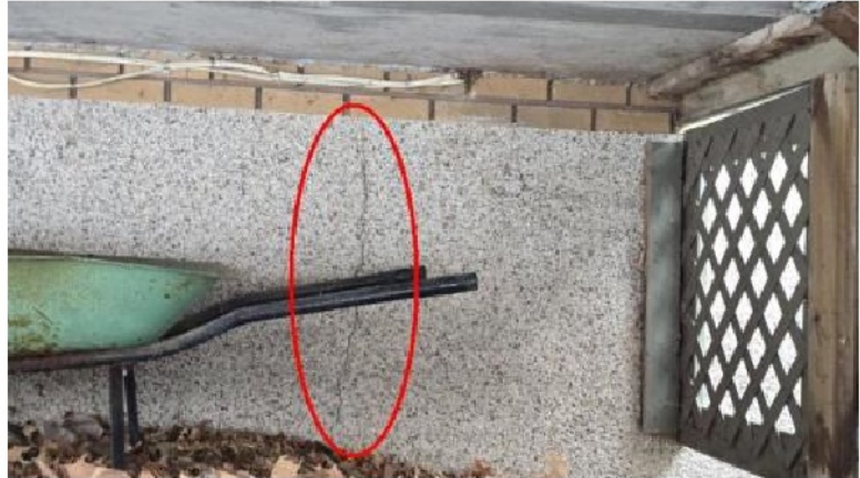
Fissures de fondation sont observées sous la terrasse.
