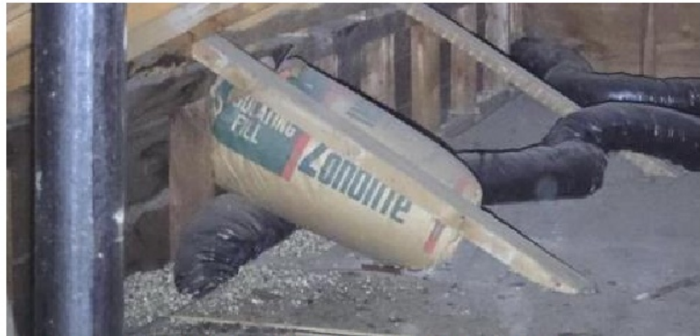
Présence de vermiculite de marque Zonolite dans entretoit.
