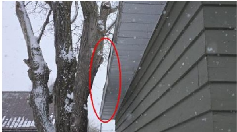
Des dommages sont observés à la bordure du toit.
